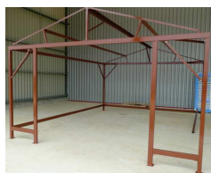
Ossature de garage montée
